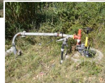
Techniques d'irrigation à partir d'une borne
